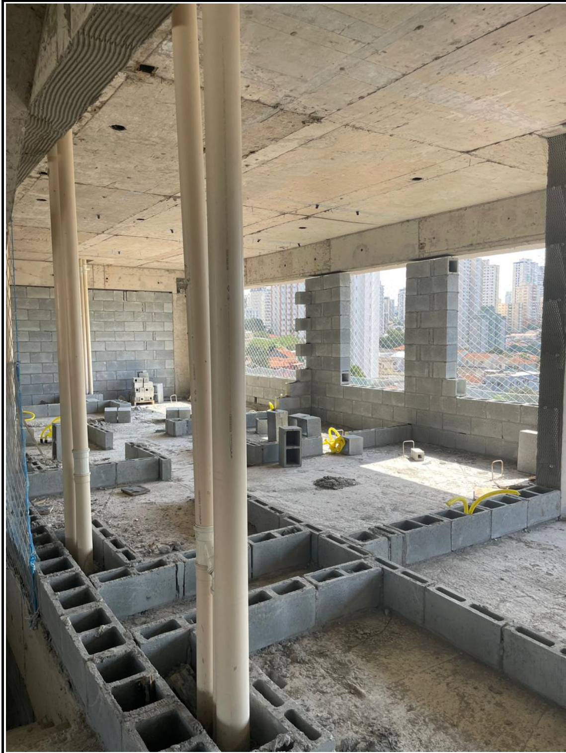
Execução de alvenaria, tubulação de elétrica e instalação de prumadas de hidráulica.
