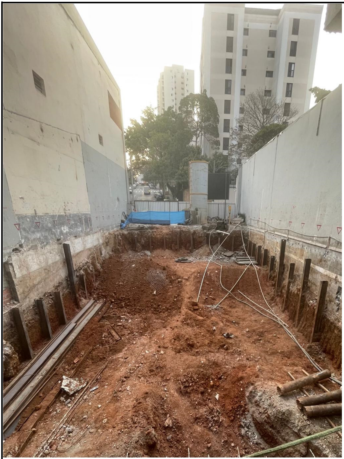
Cravação de perfil e escavação para execução da entrada - Rua Santo Irineu.
