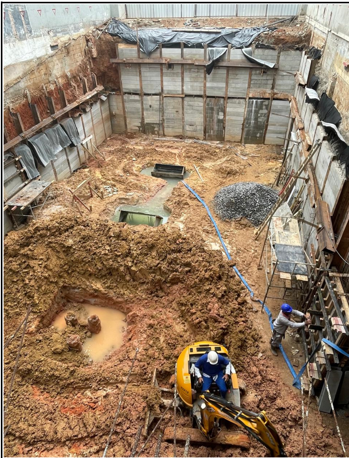
Obras para conclusão do trecho onde estava localizado o stand de vendas.
